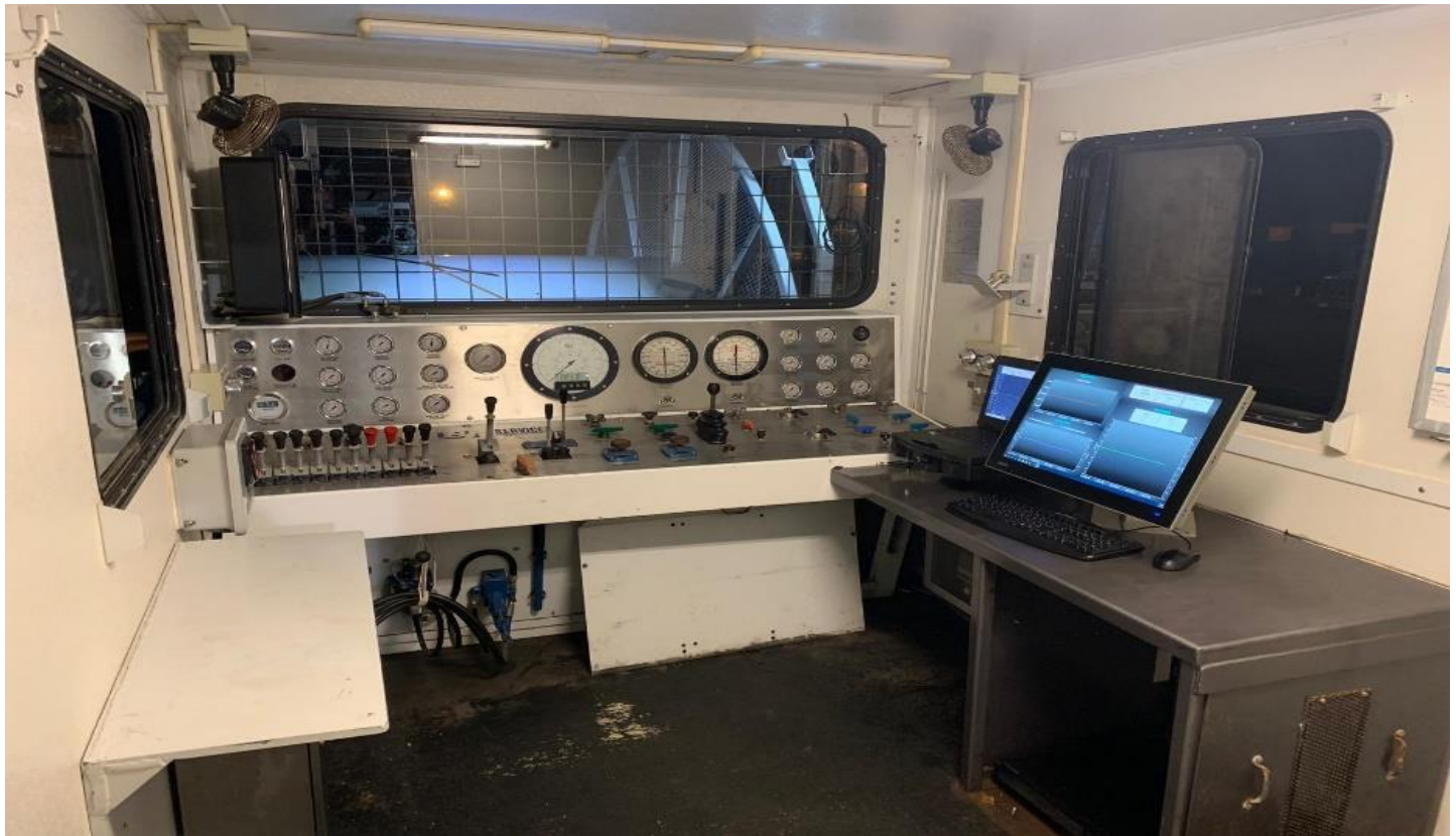
شکل ۱۴- نمایی از اتاقک کنترل یک دستگاه لوله مغزی سیار
